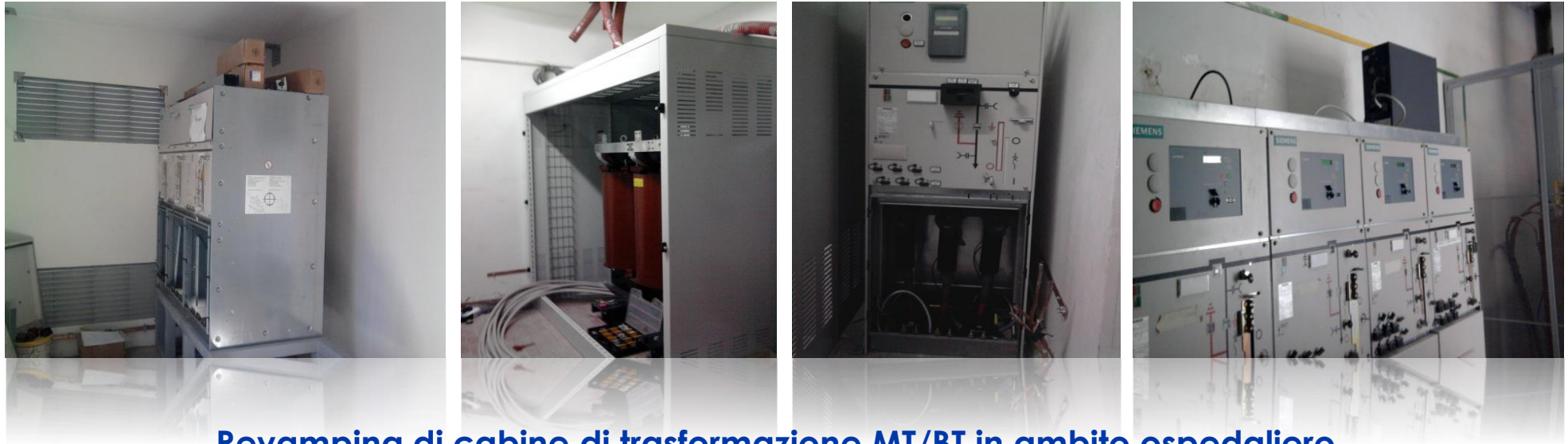
Revamping di cabine di trasformazione MT/BT in ambito ospedaliero Anno 2010
