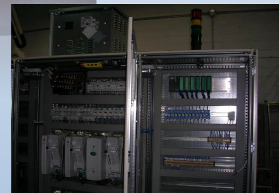
Quadro di comando e gestione per cesoia automatizzata Anno 2014
